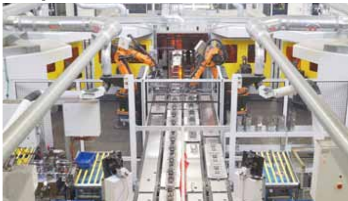
Bild 1: In der neuen Roboteranlage arbeiten Handlingsystem und Schweißtechnik Hand in Hand zusammen.
